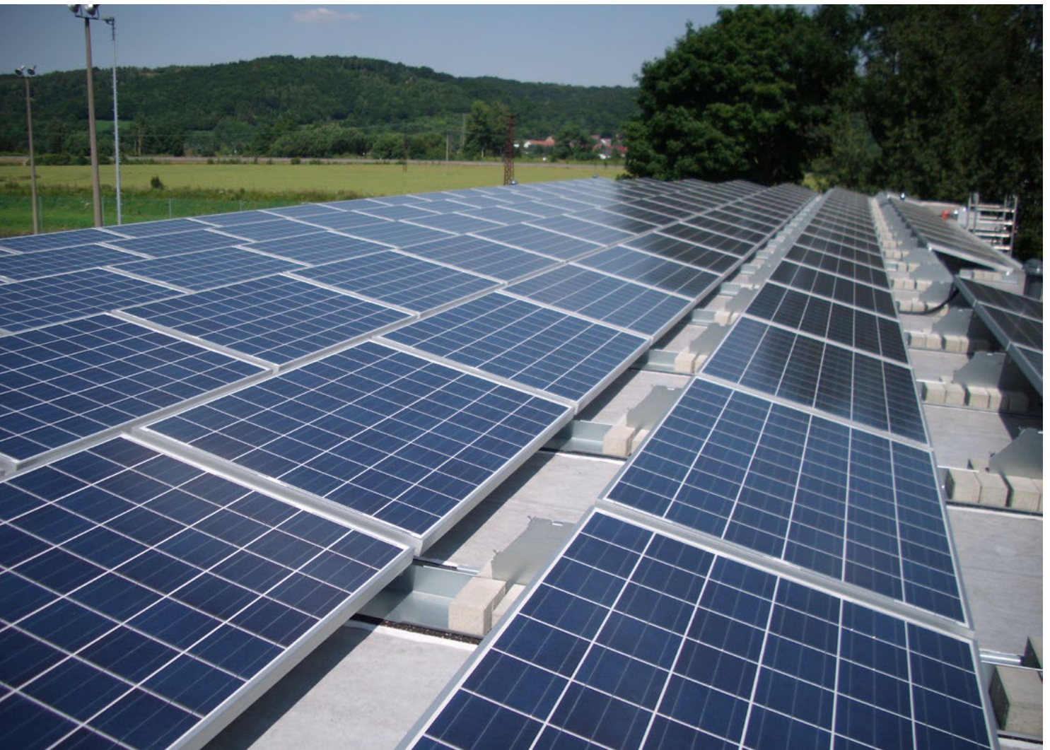
Abb. 16: Photovoltaikanlage am Sportsplatz „Am Drehling“
